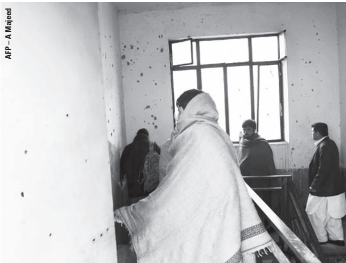
Fassungslos besichtigen diese Studenten ein Treppenhaus in der Universität von Charsadda. Die Wände sind von Einschusslöchern durchsiebt. 19 Menschen starben bei einem Massaker Anfang Januar.
