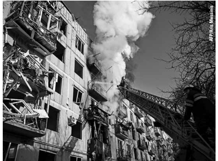
Kurz nach Kriegsbeginn gab es Bombardierungen von zivilen Gebäuden wie am 24. Februar in Tschuhujiw. Dort wurden Wohngebäude schwer beschädigt.
